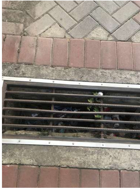
Gambar 4.108 Kondisi Drainase di Permukiman Kawasan Klitren yang Sangat Tidak Layak
