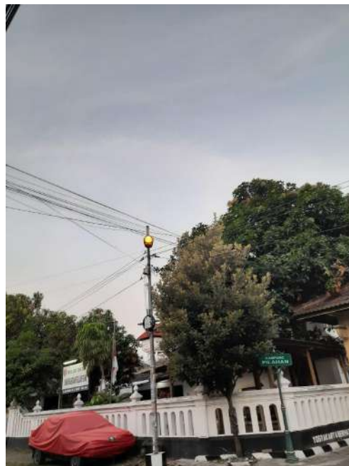
Gambar 4.147. Gangguan Penerangan Jalan Umum yang Tidak Rapi
