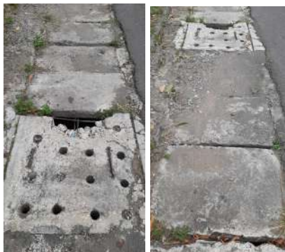
Gambar 4.89 Kondisi Tutup Plat Beton yang Sangat Tidak Layak di Jalan Ringin Putih, Prenggan, Kotagede.
