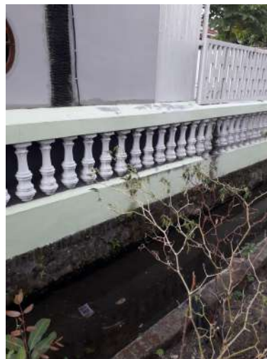
Gambar 4.92 Ketidaksesuaian Fungsi Fasilitas SAH di Jl. Semangu
