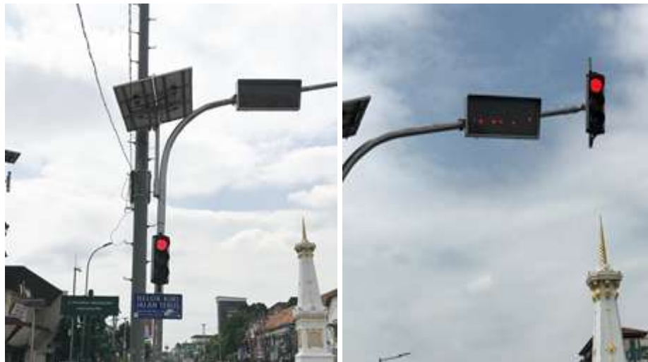
Gambar 4.65 Kondisi Counter yang Sangat Tidak Layak
