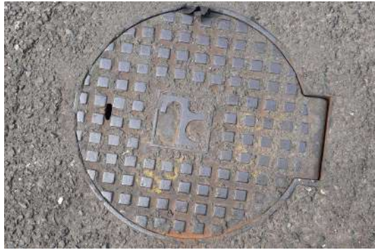
Gambar 4.135 Gambar Saluran Air Limbah yang Sering Mengalami Penyumbatan
