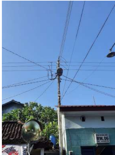
Gambar 4.141 Kondisi Fasilitas Penerangan Jalan Umum yang Masih Redup
