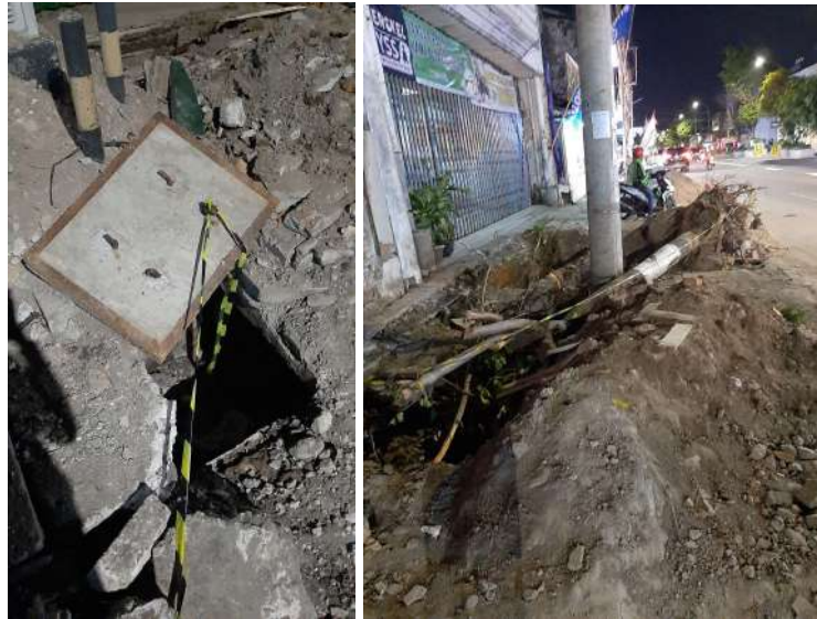
Gambar 4.7 Galian yang Mengubah Fungsi Trotoar
