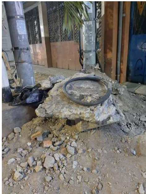
Gambar 4.4 Kondisi Trotoar yang Sangat Tidak Layak
