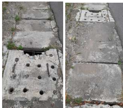
Gambar 4.89 Kondisi Tutup Plat Beton yang Sangat Tidak Layak di Jalan Ringin Putih, Prenggan, Kotagede.
