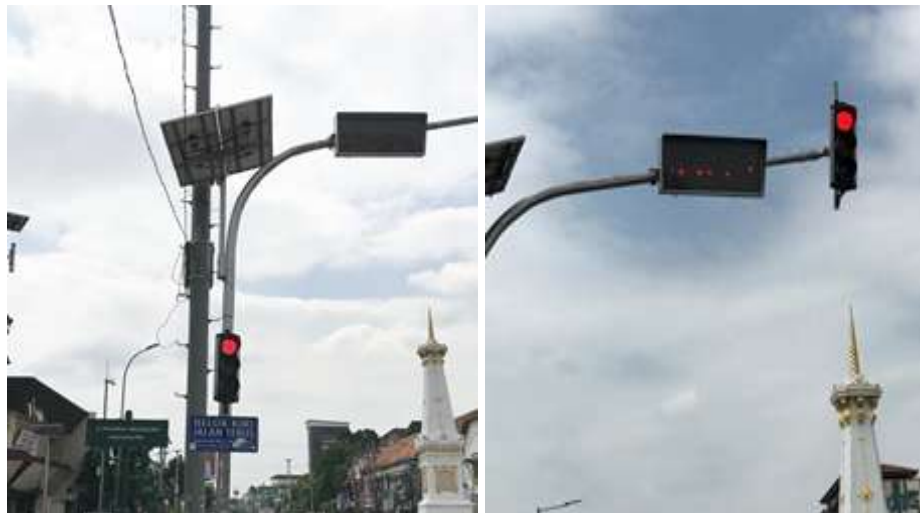
Gambar 4.65 Kondisi Counter yang Sangat Tidak Layak
