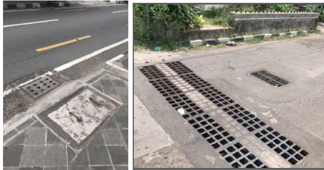
Gambar 4.88 Kondisi Fasilitas SAH Masih Layak di Jl.Tegalendu, Kelurahan Prenggan dan di Dalem RT43/RW10, Purbayan, Kotagede
