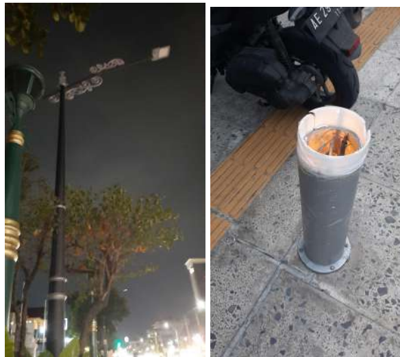
Gambar 4.49 Kondisi Lampu Penerangan Jalan dan Trotoar yang Mati Sumber: Dokumentasi Lapangan (2021)
