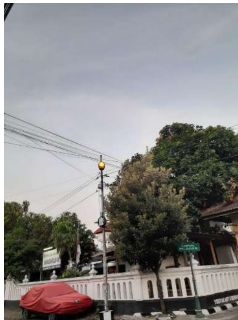
Gambar 4.147. Gangguan Penerangan Jalan Umum yang Tidak Rapi
