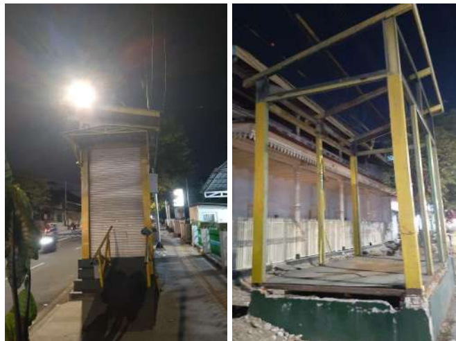
Gambar 4.30 Kondisi Halte yang Berfungsi Baik dan Tidak Berfungsi
