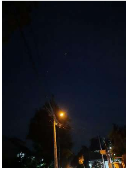
Gambar 4.148. Gangguan Penerangan Jalan Umum yang Redup
